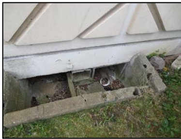
Photo N° 2722 ECH-N°30 AMIANTE CIMENT 7--Façade 2 Conduits accès vide sanitaire Ventilation (Fibres-ciment)
