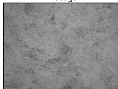
Photo N° 2788 ECH-N°65 FLOCAGE 3-Porche Plafond Flocage
