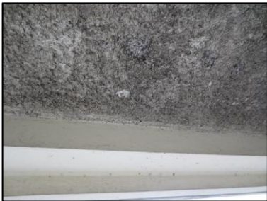
Photo N° 2654 ECH-N°4 FLOCAGE 32--Porche Plafond Flocage
