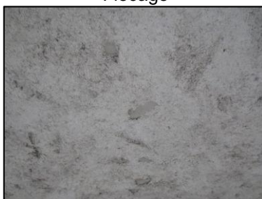
Photo N° 2787 ECH-N°64 FLOCAGE 5-Porche Plafond Flocage
